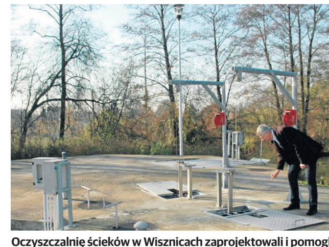
Oczyszczalnię ścieków w Wisznicach zaprojektowali i pomogli zbudować Norwegowie
