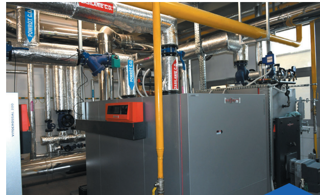
Kociołnia gazowa zamontowana w ramach projektu
