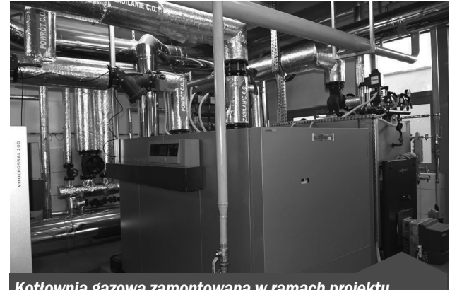
Kotłownia gazowa zamontowana w ramach projektu
