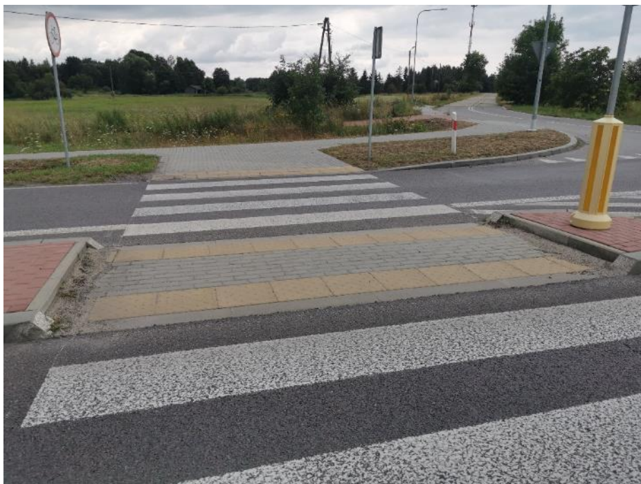
Rysunek 7. Azyl dla pieszych, obniżony krawężnik oraz linie ostrzegawcze dla osób niewidomych i niedowidzących na przejściu dla pieszych przez DW 815 w Parczewie
