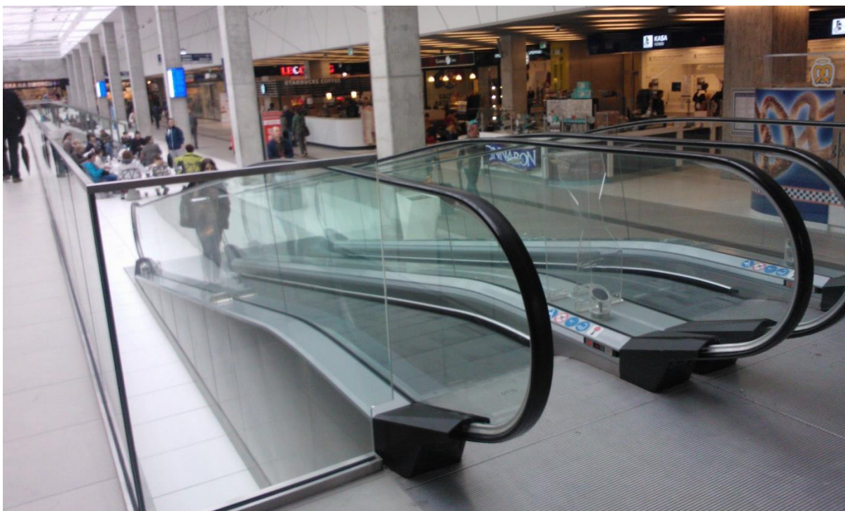
Fot. 52. Dworzec PKP Katowice: pochylnia ruchoma umożliwiająca pokonanie różnicy poziomów i wygodny transport bagaży, fot. Kamil Kowalski.
